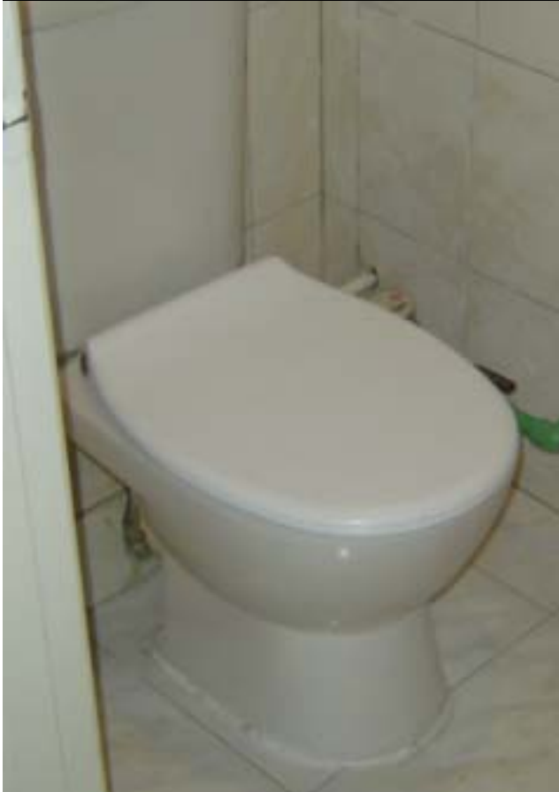
Altura insuficiente inodoro
